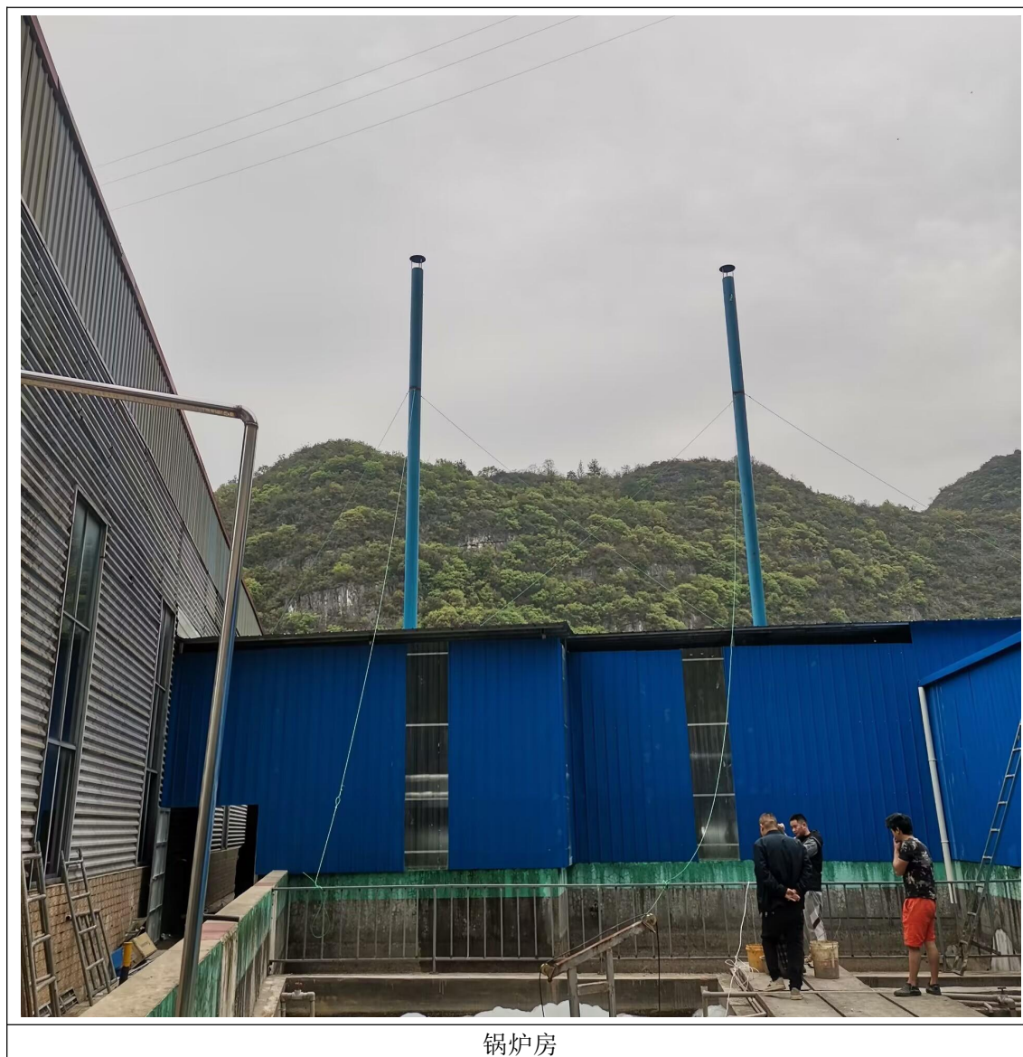
图 4.1-3 废气治理设施相关现场照片
