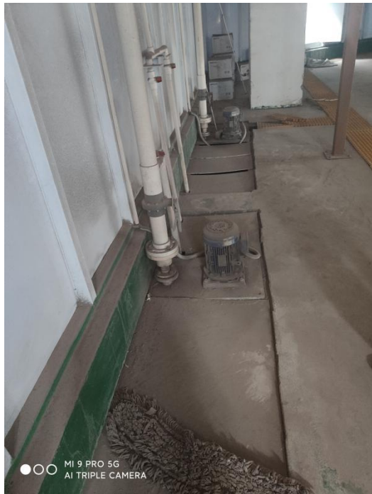
钝化液循环池
