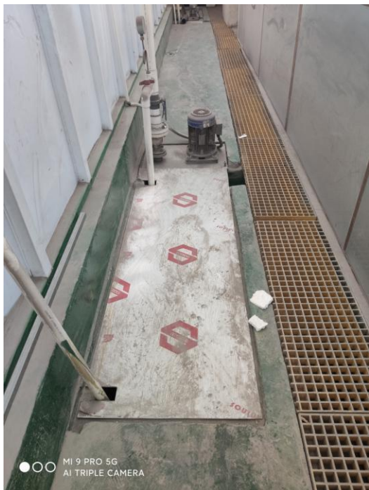
脱脂液备用池
